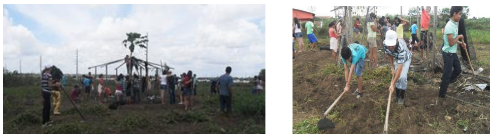
Figura 4. Mutirão realizado para a reparação de materiais e instalação do Sistema PAIS, Escola Nossa Senhora do Carmo, Bananeiras-PB, 2013.
